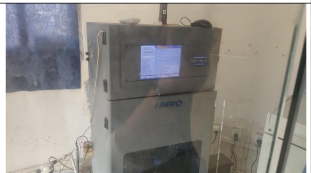
废水在线监控设施
